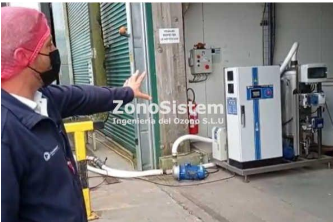
Ozono para lavado de zanahorias, Francia
