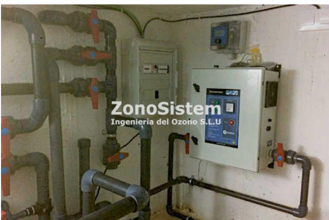
Ozono para Piscina en sótano, España.
