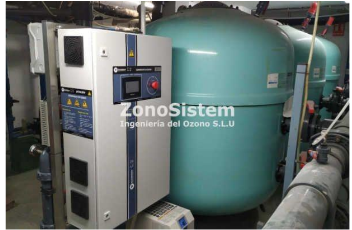
Ozono para piscina cubierta. Jerez, España.
